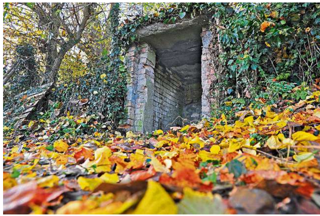
Am oberen Ende der Ohrenbrücke befindet sich eine Brunnenstube. Sie kam zutage, als nach der Ursache eines unkontrollierten Wasseraustritts gesucht wurde. Foto: Thomas Schmidt
